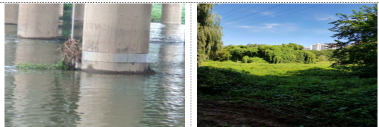
교각 및 사주, 호안 등 불안 요소
