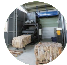
물품 포장 박스와 음식물 부산물 등 친환경 되살림 처리시설
